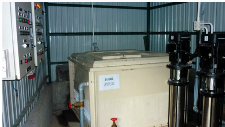
接收水務署供水的新抽水站內觀。
