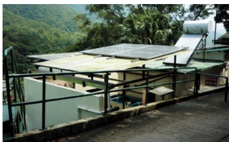
野生動物拯救中心屋頂的太陽能光伏板。
