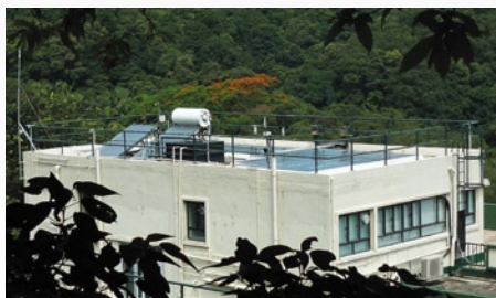
保育大樓屋頂的太陽能光伏板。
