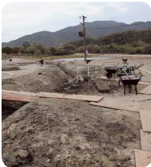
西貢大浪西灣的非法土地平整及挖掘工程。
