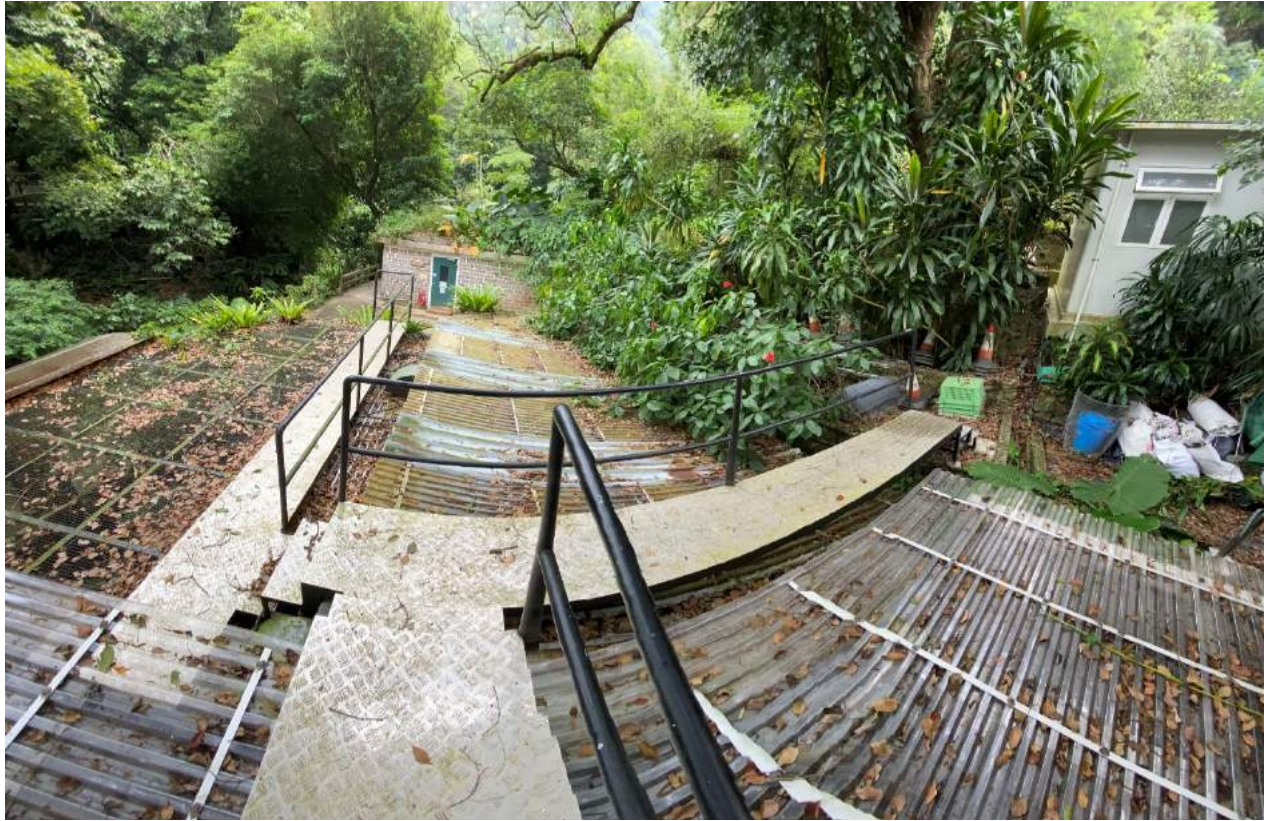
圖 21 屋頂步道及欄杆可讓工作人員安全進入設施，以進行清潔及維護工作
